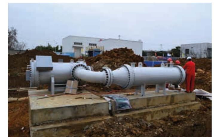
Beispiel für REITZ Retrofit Anlagenbaukompetenz: Hochdruckgebläse in China
