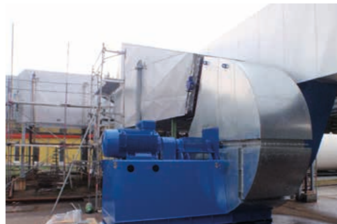
IWV-Ilmenauer Wärmeversorgung , Einbindung eines Kanals inkl. des Ventilators in ein bestehendes System mittels Bypasskanal und Absperrklappen
