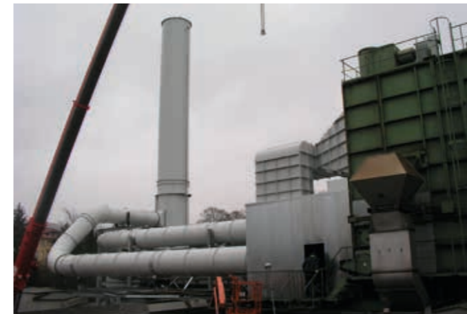
Beispiel für REITZ Retrofit Anlagenbaukompetenz: Modernisierung Kamin und Rohrsysteme
