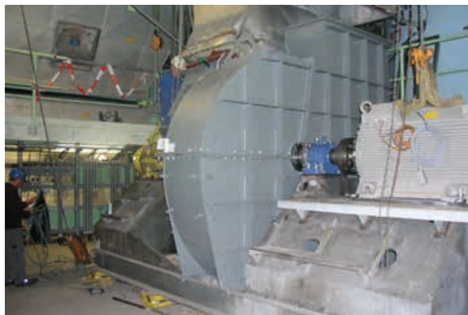
SWB, MVA Bonn , Ertüchtigung von sechs vorhandenen Saugzügen inkl. Umrüstung der bestehenden Ventilatoren von Drall- auf Drehzahlregelung
