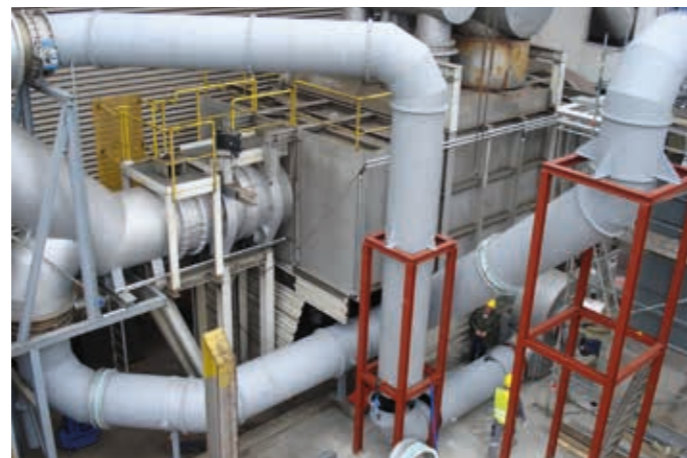
Badische Stahlwerke Kehl , Herstellung und Montage aller Rohrleitungen, inklusive Stahl- und Ständerwerk, Lieferung und Montage von Saugzug- und Frischluftgebläse
