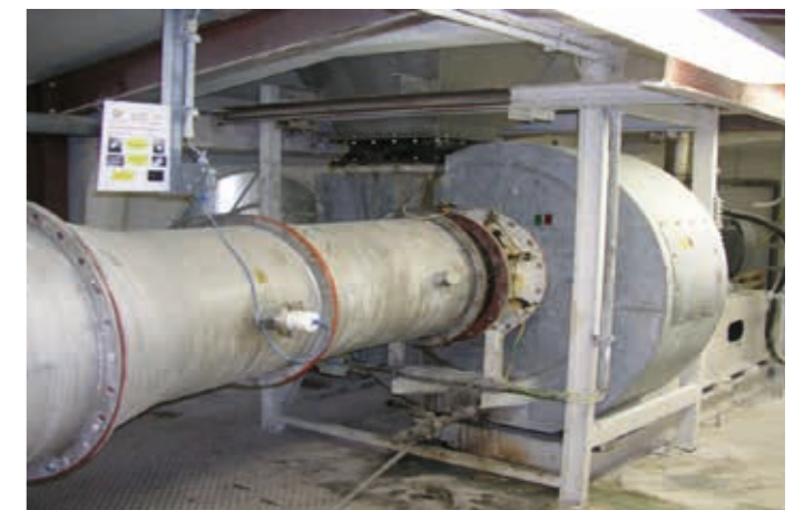
Granotec , Austausch von zwei KXE Ventilatoren, De- und Montage, Umrüstung von Drall- auf Drehzahlregelung
